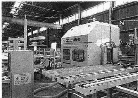
本社工場に設置した新ライン
